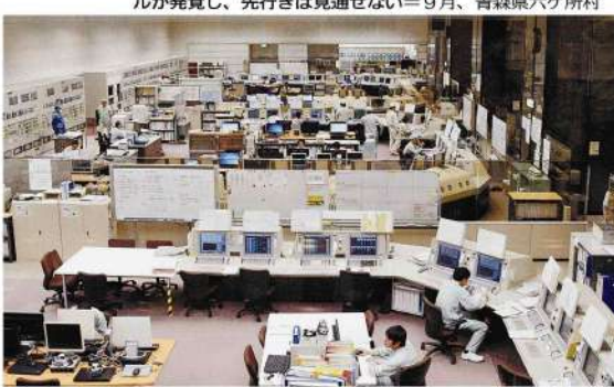
日本原燃六ヶ所再処理工場の中央制御室。新たな重大トラブルが発覚し、先行きは見通せない＝9月、青森県六ヶ所村
